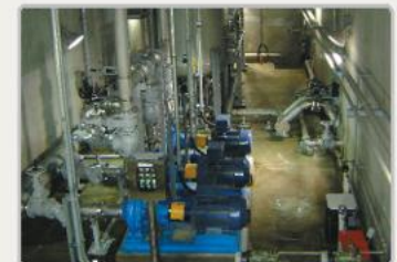
지하설비등 (오존용해 접촉장치 및 순환수 펌프)
